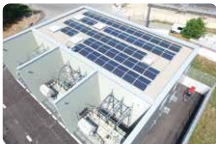
Poste de transformation 125/20 kV, Gland (automne 2014)
