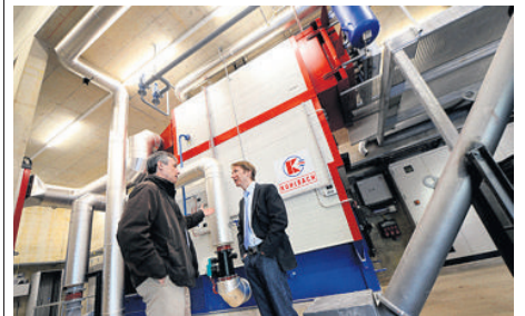
Dieter Gisiger, directeur de la SEIC, qui fournit le chauffage à Eikenott, et Thierry Denuault, de Losinger Marazzi, qui a construit le quartier, devant le four à bois. ALAIN ROUÛCHE
