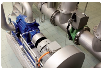
Turbine – Réservoir de Château-Grillet
