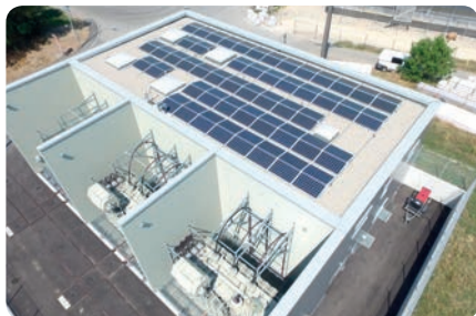
Poste de transformation 125/20 kV, Gland [automne 2014]
